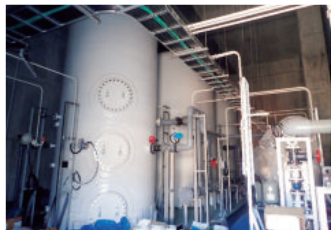
清浄海水導入施設（ろ過装置、貯水槽）
